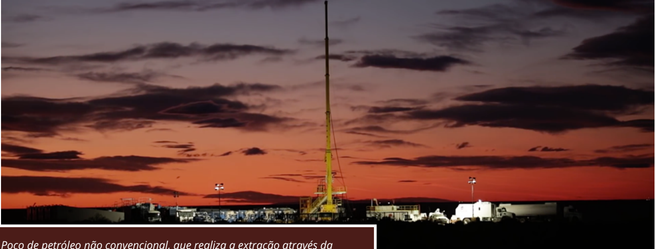
Poço de petróleo não convencional, que realiza a extração através da fratura hidráulica (Fracking), na Argentina. (Foto Vaca Bonsai Audiovisual).
