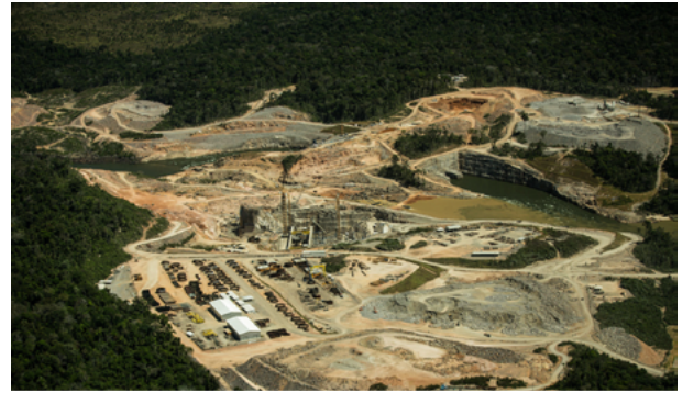
Construção da usina Teles Pires, no rio Teles Pires. Com cinco barragens o complexo hidrelétrico no rio está afetando a vida das pessoas na região. O Teles Pires corre ao lado do rio Juruena e forma o rio Tapajós. (Foto: Thiago Foresti/Forest Comunicação).
